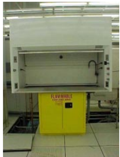
Aisle 3 Fume Hood
